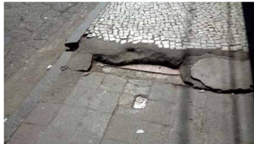
189 RUA CALDAS VIANA – DIFERENÇA DE NÍVEL EM TRECHO CONTÍNUO, COM O AGRAVANTE QUE ESSA CALÇADA TEM UM INTENSO FLUXO DE PESSOAS
