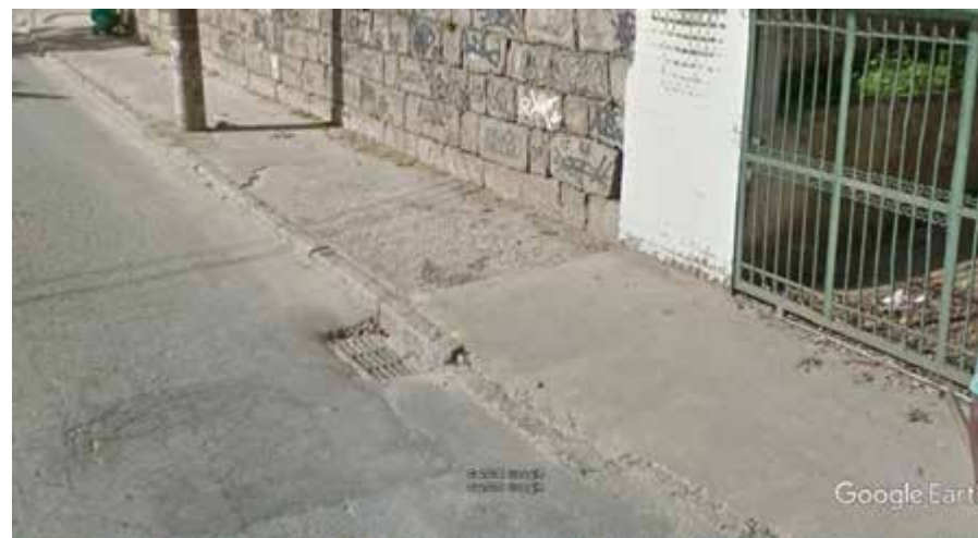
190 RUA CORONEL VEIGA – PISO IRREGULAR
